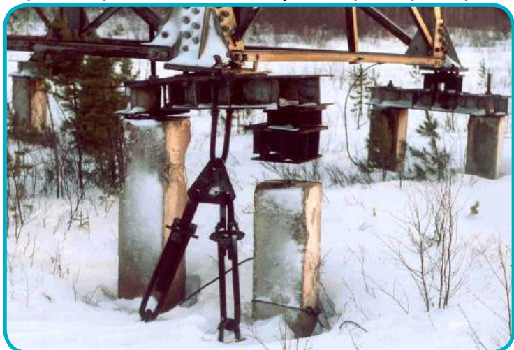
Рис. 1. Аварийное опирание анкерно-угловой опоры ВЛ 220 кВ на фундаменты по причине потери заделки железобетонных свай в морозопучинистом основании и их не-равномерном выпучивании (на переднем плане: специальное забивное либо вибропогружаемое анкерующее устройство разработки ОАО «Институт Энергосеть-проект» [6]; фото: 10.2003)
