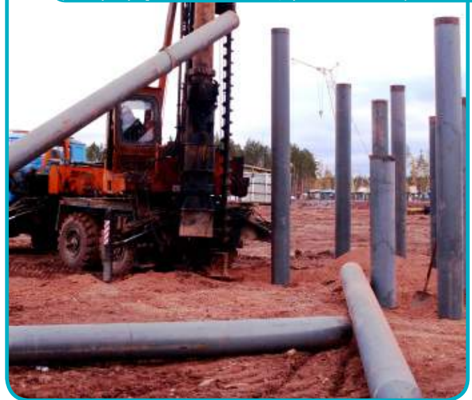
Рис. 4. Бурильно-сваебойная машина БМ-811М: бурение лидерных скважин диаметрами 150-400мм и копровая забивка 500 свай стальных труб-свай диаметрами 168-426мм с конусными наконечниками на глубину 6-11м в выветрелые аргиллиты при обустройстве Дулисьминского месторождения (север Иркутской области, фото: 11.2010)
